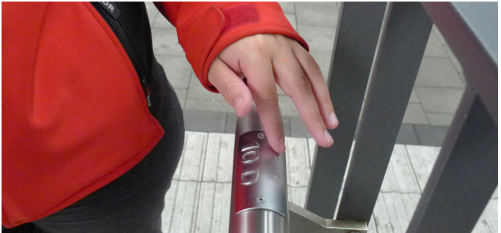
Relief- und Braille-Gleisbeschriftung auf einem Handlauf
