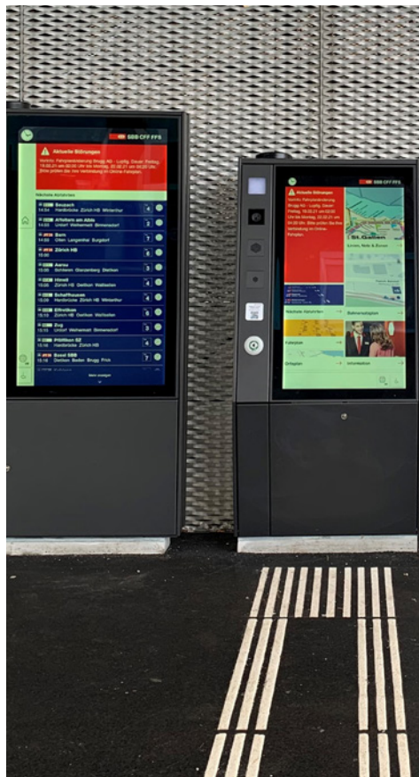
«Smart Information Displays» SID 55 et 46 avec marquage tactilo-visuel au sol
